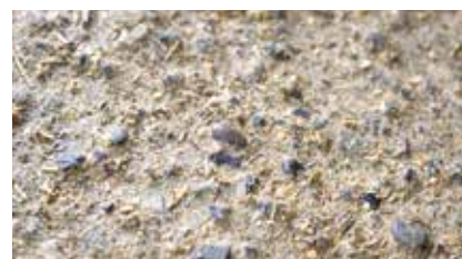
Bakterierisiko på betong
