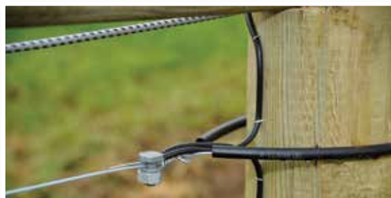
Bilde 23. Sikker trådkobling fra apparat til gjerde.
