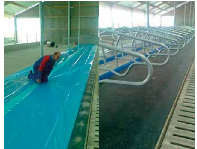
Foto's tijdens en na installatie bij Tom Geene Li.: De matras wordt goed ingepakt tegen vocht Re.: De achterrand loopt af voor een goede hygiëne
