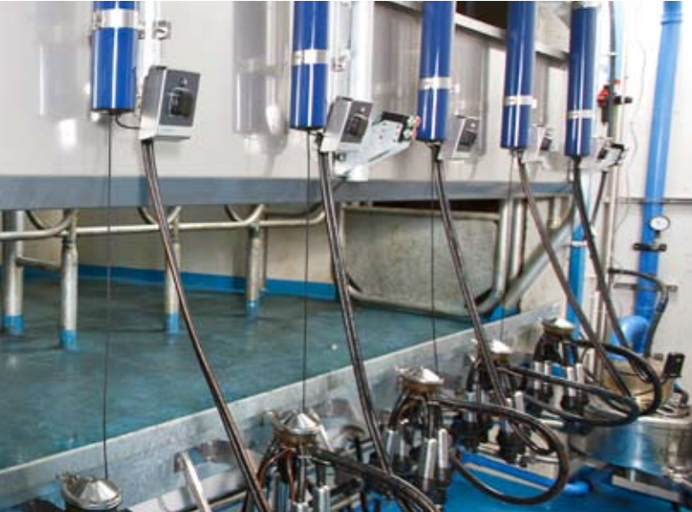
Pilote de traite MPC150 DeLaval dans une salle de traite parallèle P2100 DeLaval
