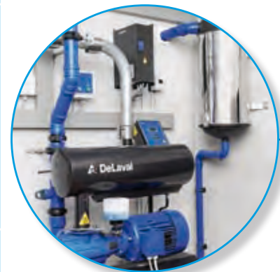
Vakuumpumpen mit NFO Frequenzsteuerung
