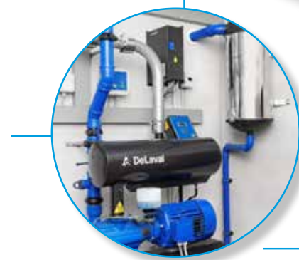
Vakuumsystem med DeLaval NFO
