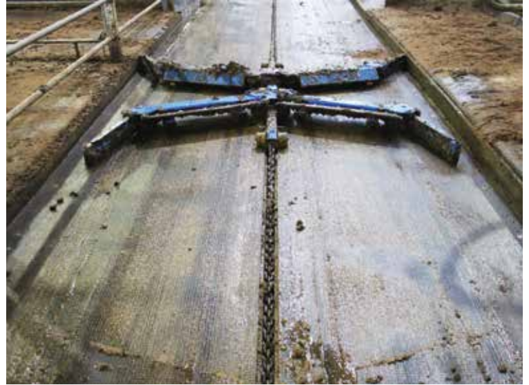
Avokouruista oli päätetty jo ennen ensimmäisiä tarkempia suunnitelmia. DeLaval AKD ketjulannanpoistojärjestelmä avokouruun päätettiin viime hetkellä. Kumpikin päätös oli tilan väen mukaan ehdottomasti oikea.
