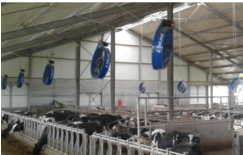
Vaakapuhaltimet puhaltavat yläviistosta ja niiden avulla puhallusteho käytetään tarkemmin hyödyksi, kun ne sijoitetaan makuuparsien tai ruokinta-aidan päällä jonoon, mutta niiden avulla saadaan kohdennettua jäädytystä myös poikkipuhalluksessa.
