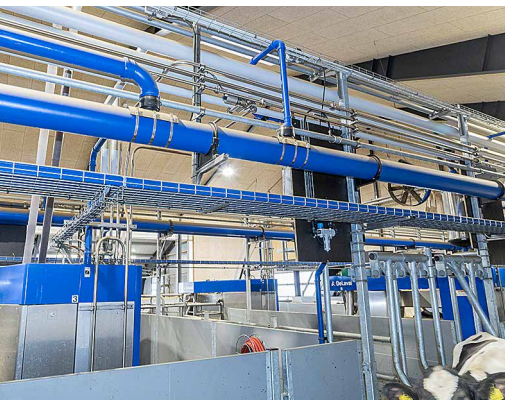
Beim VMS Batch Milking-System von DeLaval sind kostensparend alle Luft-, Wasser- und Milchleitungen oberirdisch verlegt.
