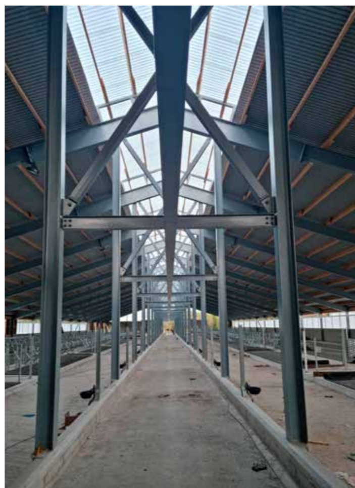
Fodret kommer att distribueras med en rälshängd distributionsvagn ORW.
