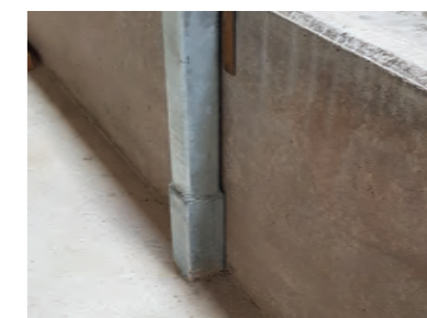
Vid foderbordet har man i samråd med Robin Hast, distriktssäljare på DeLaval valt stolpar med utanpåliggande rostfri hylsa. Det ger en ökad livslängd för stolpen och minimerar risken för galvanisk korrosion.
