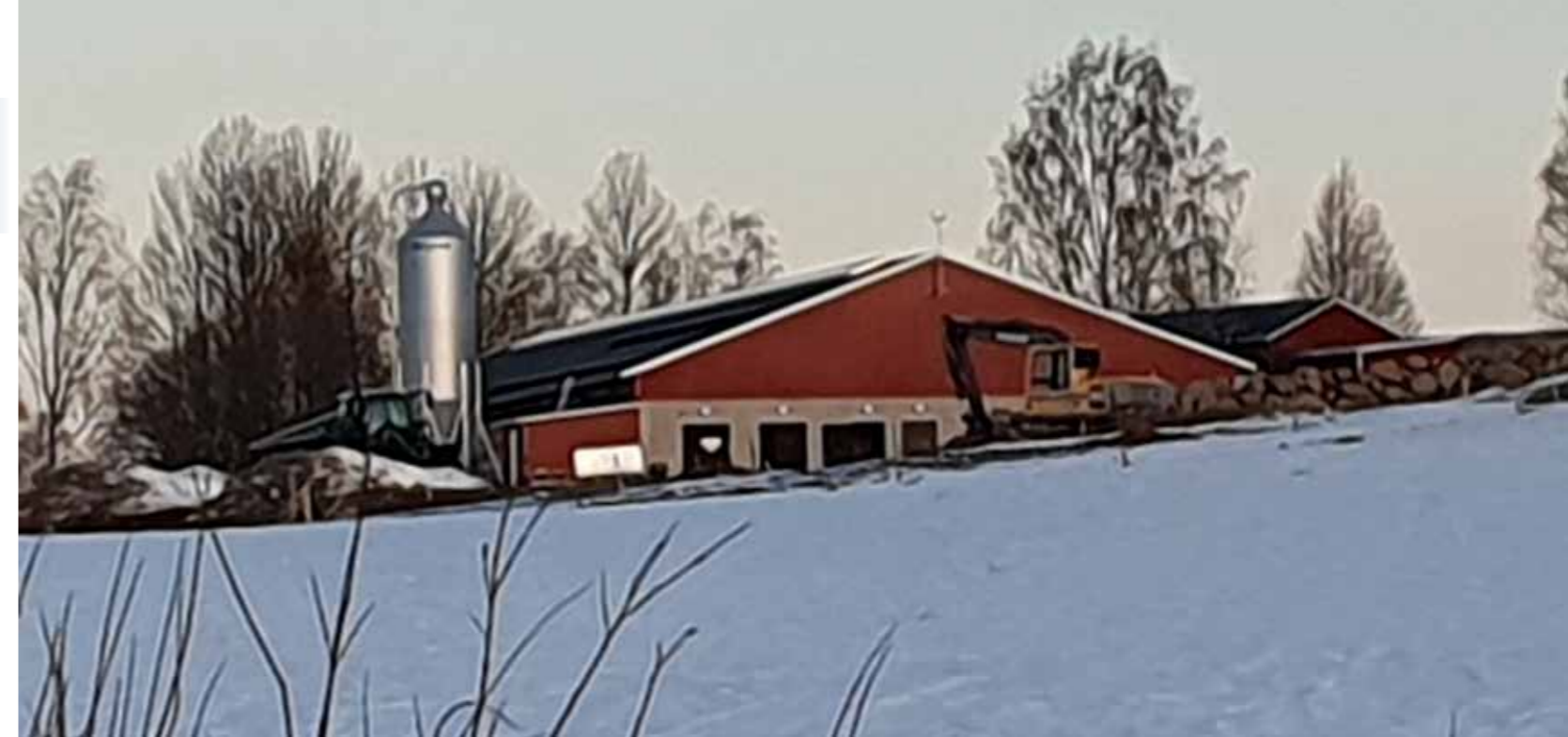
Det nya stallet ligger vackert i en sluttning. Anders fick fylla ut med 3000 kubik för att få en tillräckligt stor plan yta.
