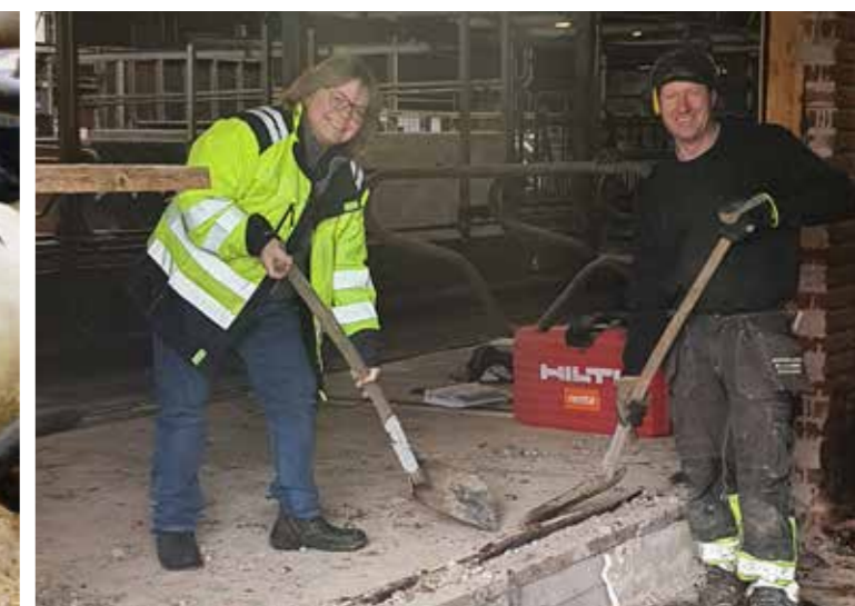
Den 15e mars togs det första spadtaget. På bilden är Ulrika Nilsson och Jörgens Bygg.
