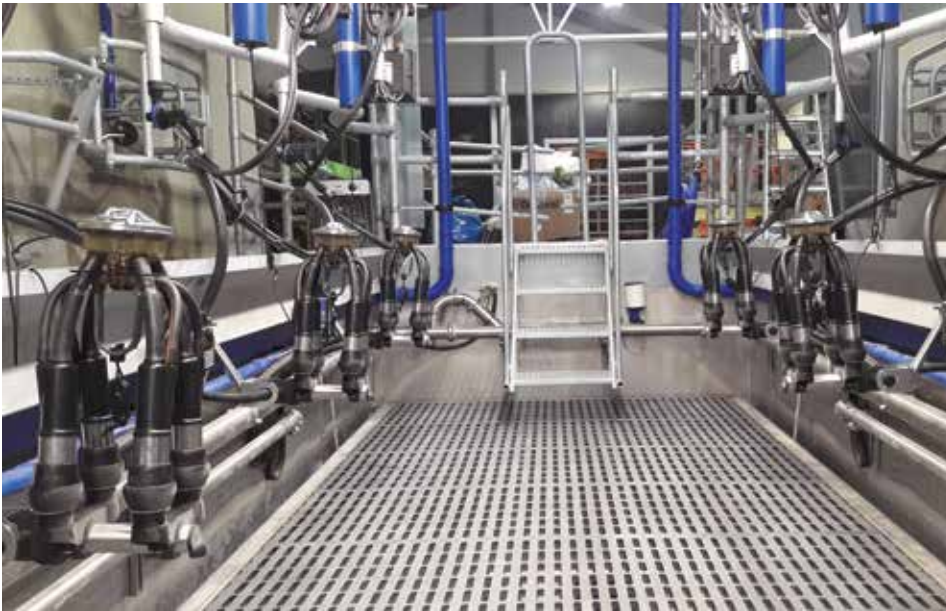
Här är det höj- och sänkbara golvet på plats liksom mjölkkrör, mjölkkningsorgan och mjölkkningsenheter.
