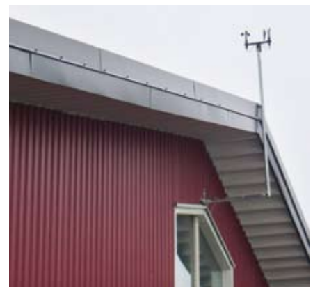
Kuvassa sääasema ”ilmaa vatkaavine jäätelökuppeineen” mittaa koko ajan tuulen nopeutta ja suuntaa. Samalla ohjauskeskus avaa ja sulkee saamansa tiedon pohjalta harjan ja seinien luukkuja pitäen sisäilman lämpötilan halutussa arvossa.
