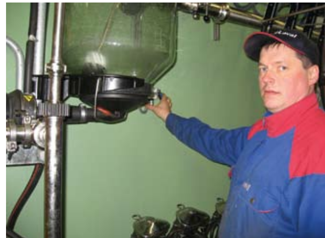
DeLaval huoltoteknikko Teijo Karppinen viimeistelee lypsykoneen asennusta ja testaa AirPurge –ilmanpäästöventtiiliä, jolla maidon siirtolinja päätelaitteelta tilasäiliöön saadaan täysin tyhjäksi. Vuodessa se merkitsee n. 1500 litraa enemmän maitoa meijeriin.
