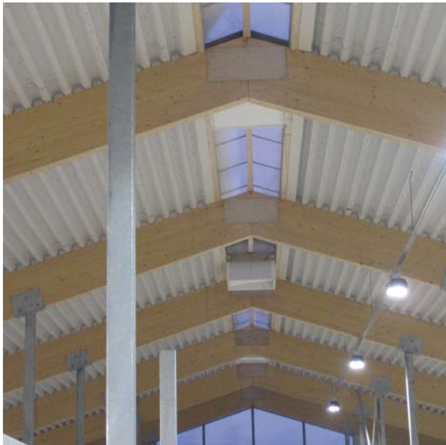
Harjaikkunat on tuettu pitkittäisillä liimapuupalkeilla, jotka ovat 9x27cm. Ilmanpoisto tapahtuu poistohormeista luonnollisena. Valoa harjalta pääsee sisälle vajaan metrin leveydeltä. Navetan valaistus on hoidettu DeLaval kirkasvalolampuilla.
