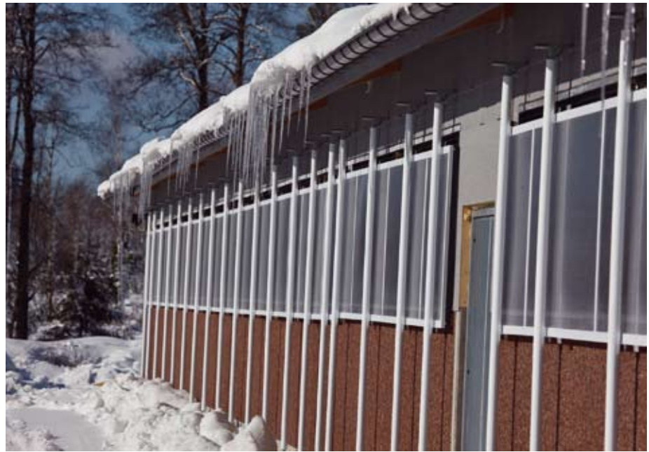
Ylös-alas-suunnassa liikkuvat nostopaneelit päästävät valoa sisään ja eristävät talvella.
