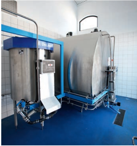
Vasemmalla oleva BVV-puskurisäiliö on välivarastona maitoauton käynnin ja tilasäiliön pesun ajan. Puskurisäiliö peseytyy auto-maattisesti käytön jälkeen.
