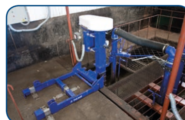
Sähköpumput ja sekoittimet
